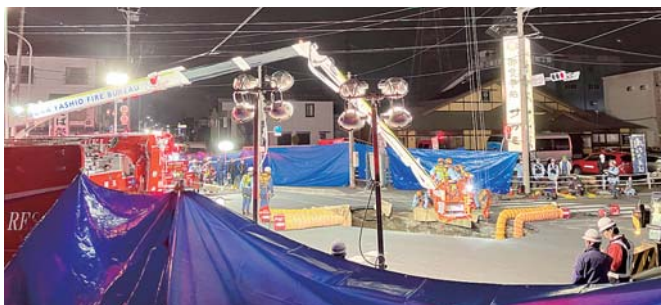
八潮市の道路陥没事故
