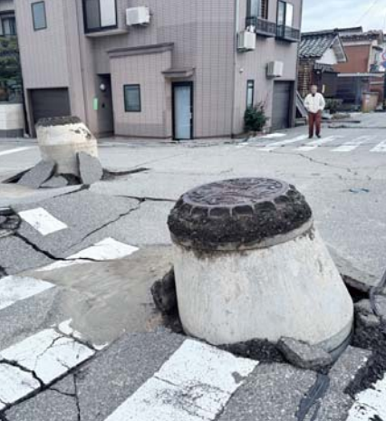
能登半島地震では下水道施設にも大きな被害が発生した
