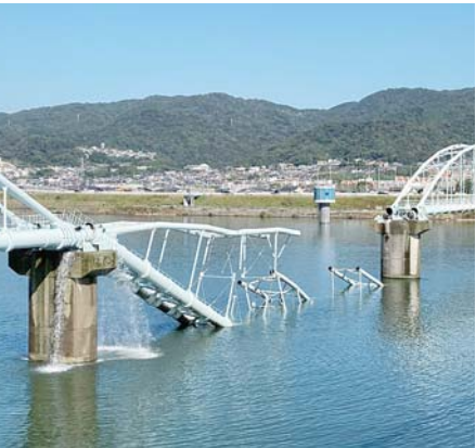
一昨年10月に発生した和歌山市の水管橋崩落事故
