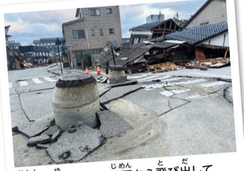
地震の揺れにより地面から飛び出してしまったマンホール (輪島市)
