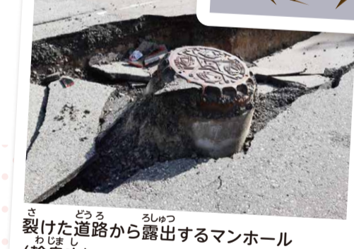
裂けた道路から露出するマンホール (輪島市)
