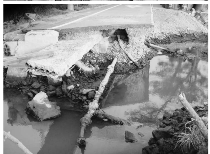
水道施設の被災状況(上:橋元、下:豊浦田浜)
