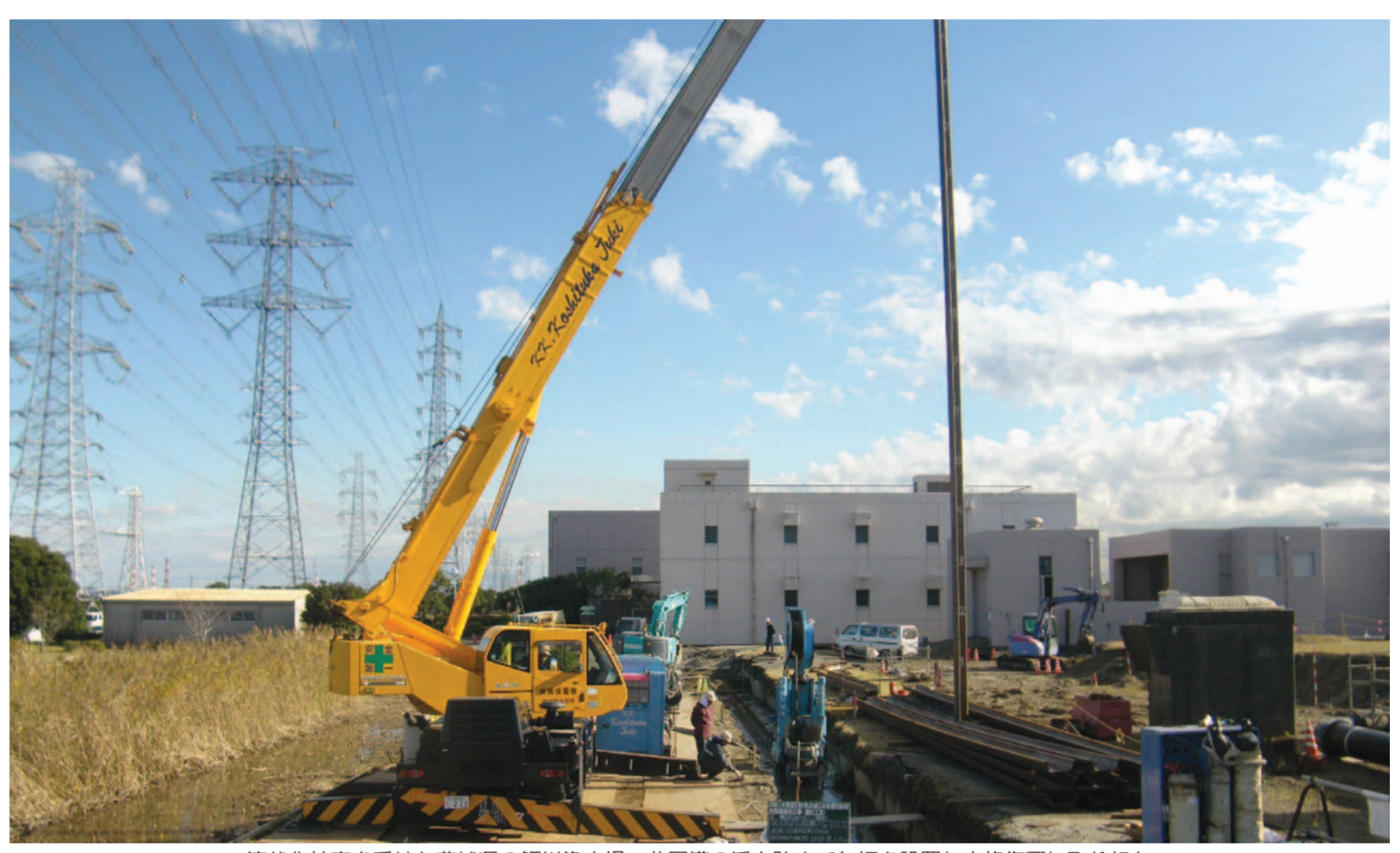
液状化被害を受けた茨城県の鶴川浄水場。共同溝の浮上防止で矢板を設置し本格復興に取り組む
