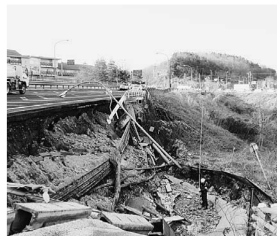
国道4号では路面が崩落
