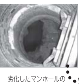
劣化したマンホールの 防食ライニング
